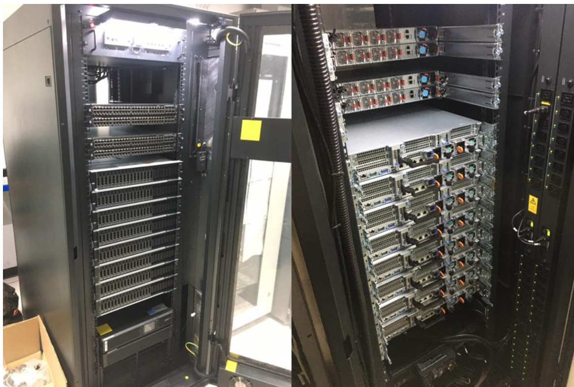
รูปภาพที่ 47 อุปกรณ์เซิร์ฟเวอร์ที่ติดตั้ง พร้อมใช้งาน
