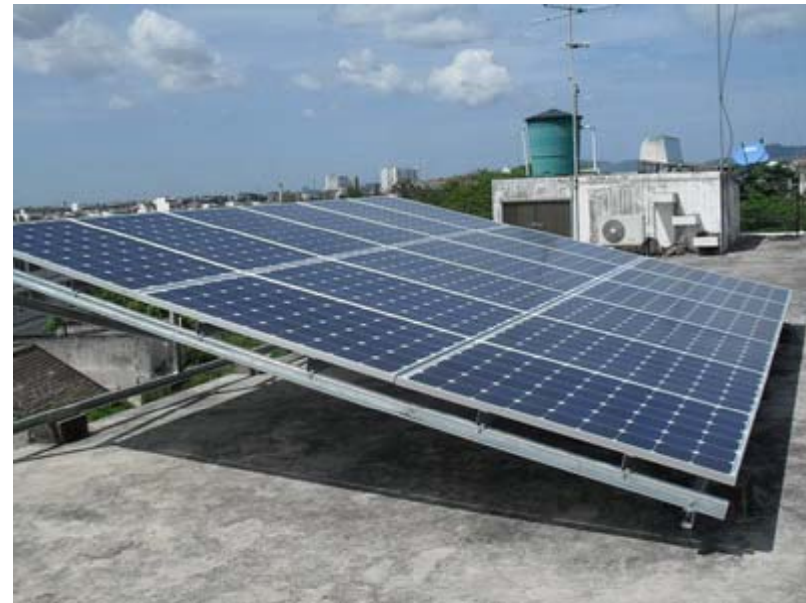
3.6 kWp, Mr. Montri Uwanno, Hadyai. (2010)
