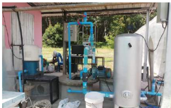
ระบบควบคุมน้ำ Smart Think
